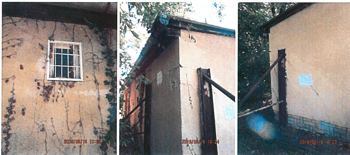
Fürdőszoba ablak, az épület szerkezeti hibái
