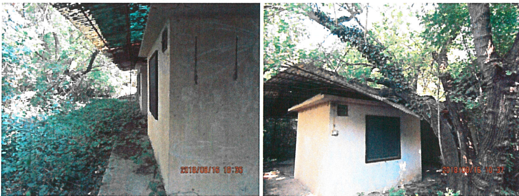
Az épület melletti járda, beszakadt tető
