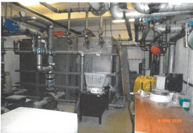
69. Pincszint, hidrofór (2986/0/A/2 hrsz.)
