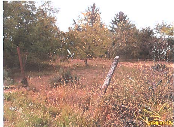
Rossz állapotú kerítés
