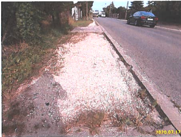
Burkolat nélküli járda az ingatlan előtt
