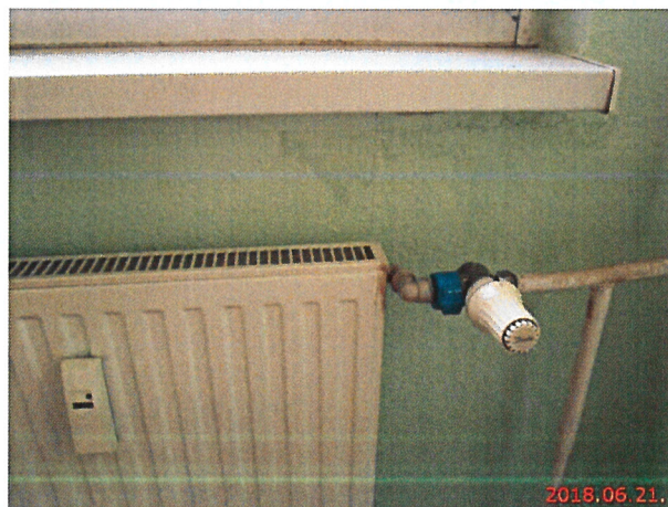
radiátor, hőmennyiség mérő, ablak alatti beázás
