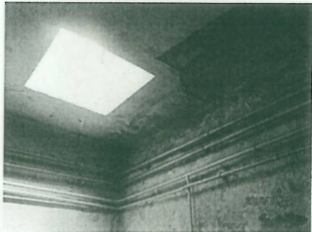
Pinceszint, bevilágító ablak melletti beázás
