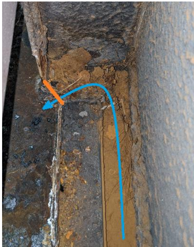
69. ábra. A P1 szerelvény egyik ajtó vezetőcsínje a burkolat lebontása után. Kék: „a víz útja”, Narancssárga: „a megépítendő gát” [61]
