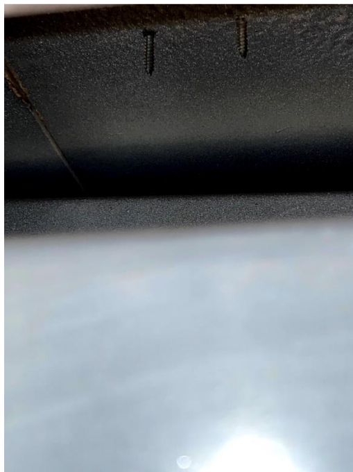
56. ábra: A padlószervezetből véletlenszerű helyeken „érkező” lemez és facsavarok Járműszemle 2020.07.03-án
