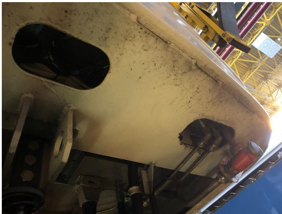
58. ábra: Korróziós károsodás veszélyét rejtik az szakaszos varratokkal kialakított burkolat elem illesztések, különös tekintettel a járművégeken, Járműszemle 2020.07.03-án
