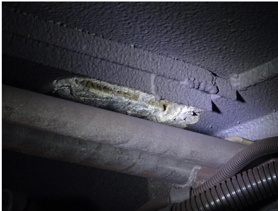
61. ábra: Korróziós károsodás sebességét fokozó klór jelenléte, folyásnyomokban rakódik le, Járműszemle 2020.07.10-én
