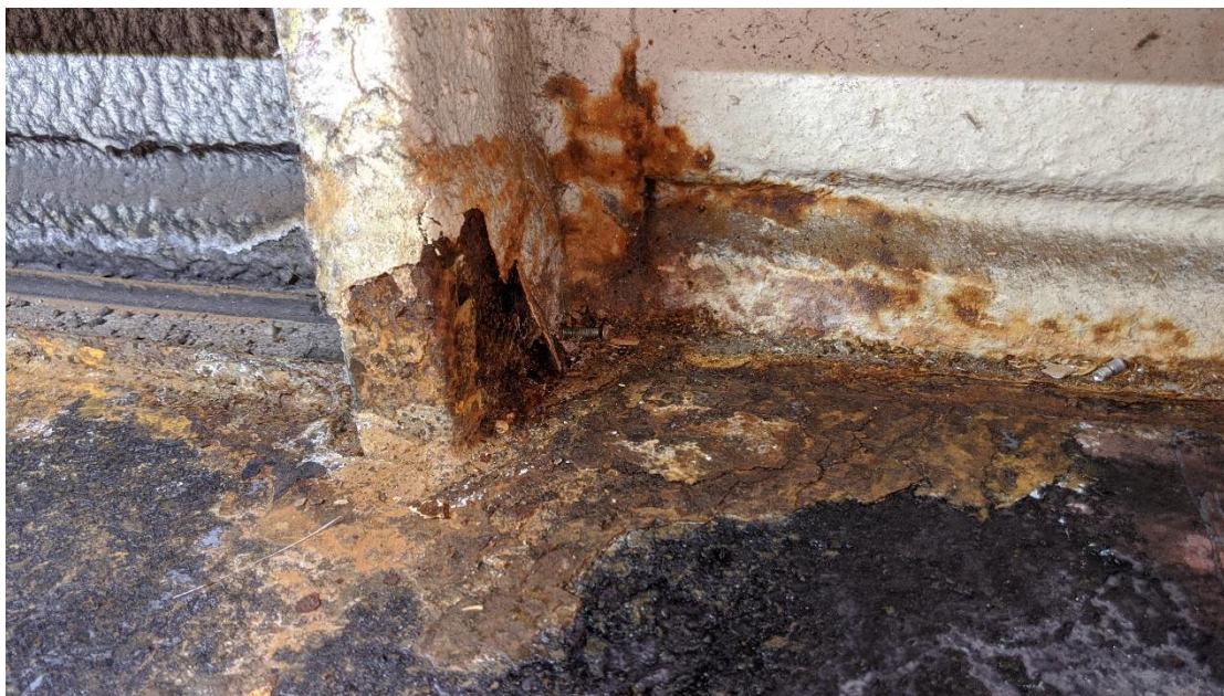
64. ábra: Erős korrózió a P1 szerelvény padlóján, amely az oldallemez és az oldalsó U oszlopok alsó részét is elérte [61] (2019.12.05.)
