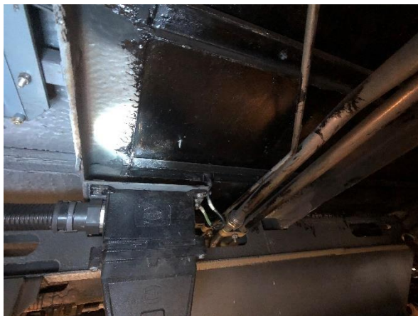
74. ábra. A P1 jármű padlójavítást követő eltérő alvázvédő bevonatai, járműszemle 2020.07.17.
