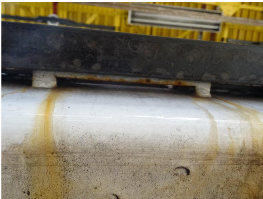
48. ábra: A 668 psz. motorkocsi utasbejáró küszöb szerkezet mögötti vízfolyás nyoma, járműszemle 2020.07.03-án
