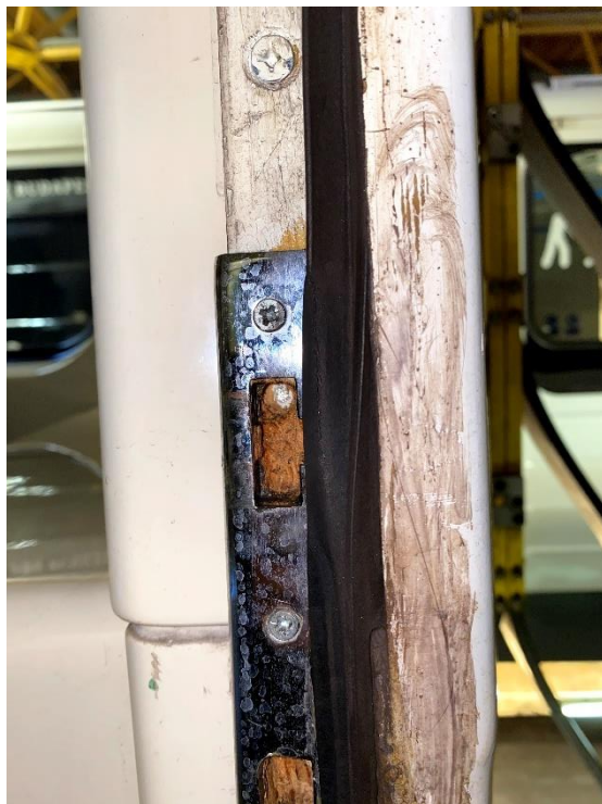
50. ábra: A 668 psz. motorkocsi homlok átjáró ajtó zárszerkezet, nem felfekvő tömítéssel 2020.07.03-án
