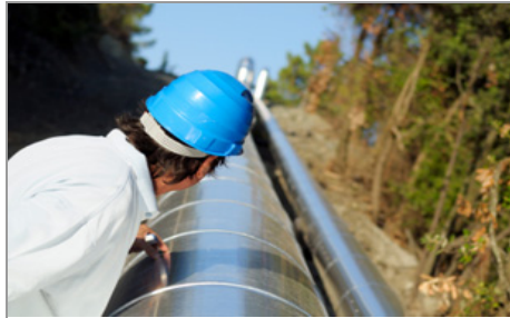
Távfűtő gerincvezeték (forrás: estar)
