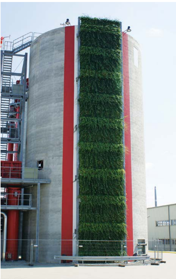
191–193. ábra Homlokzatburkolatként viselkedő kúszónövények
