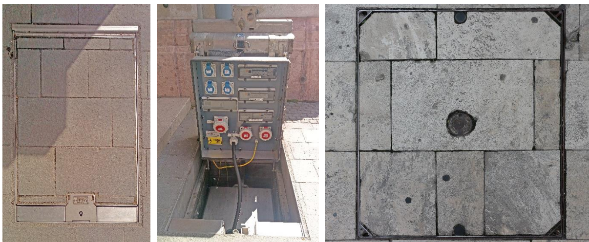
Burkolatba rejtett közműelemek
