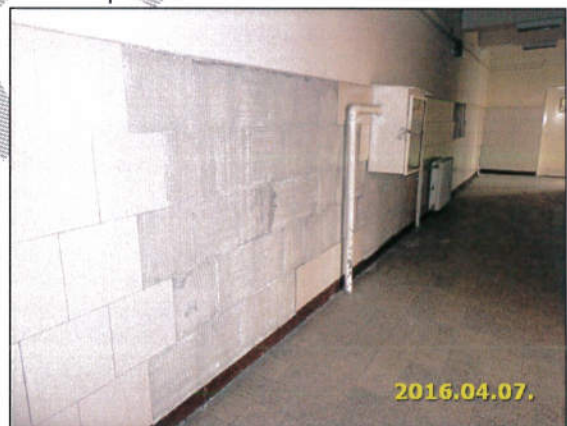
Dilatációs hibából adódó burkolathullás
