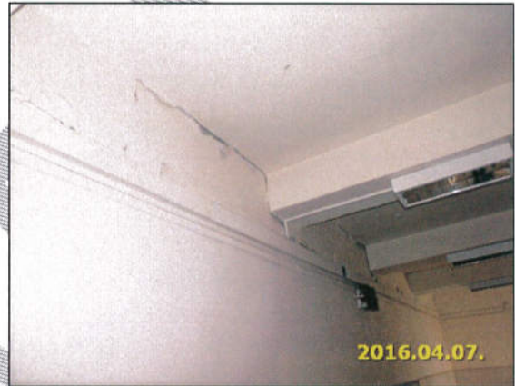
Dilatációs repedés a bal oldali épületszárny földemkapcsolatánál
