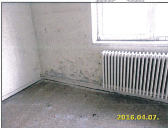
Pince szintű falazat szigetelési hibájából adódó felvizesedés
