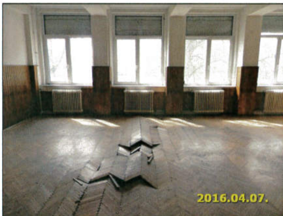
Fűtési rendszer meghibásodása miatti burkolat felázás
