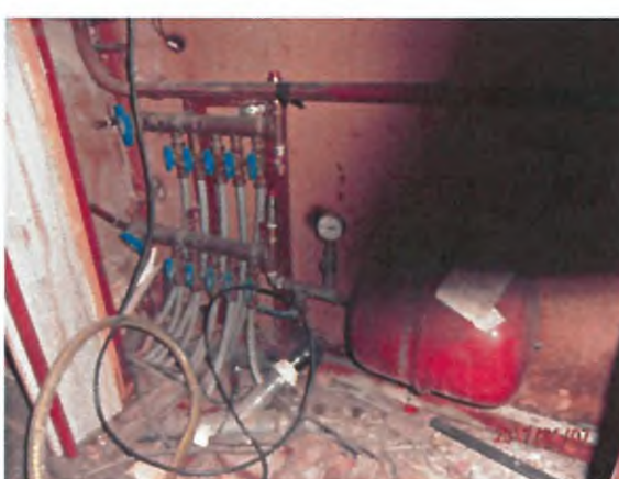
Földszint - Fűtés vezetékek, kiegyenlítő tartály
